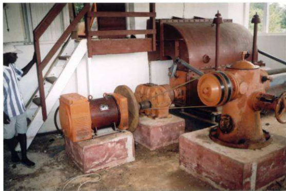
Figuur 5 - Machinehuis met elektromechanische apparatuur
